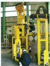
機械部分の点検
