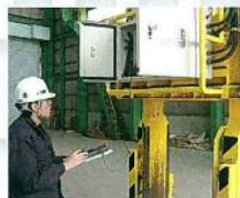
電気品の作動確認及び各種測定
